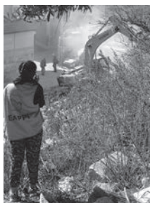
Eine EA fotografiert eine Hauszerstörung im November 2016 in Al Is-sawiyah, Ost-Jerusalem.
